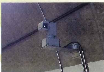
トンネル内監視カメラ
