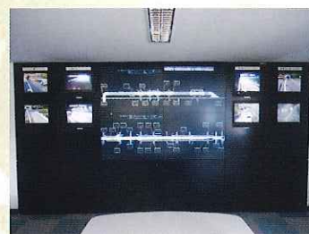
監視制御モニター
