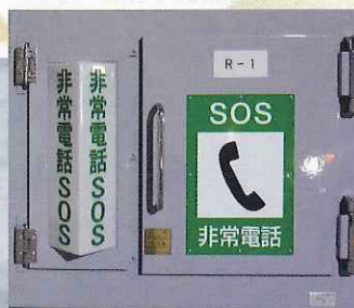
トンネル内非常電話
